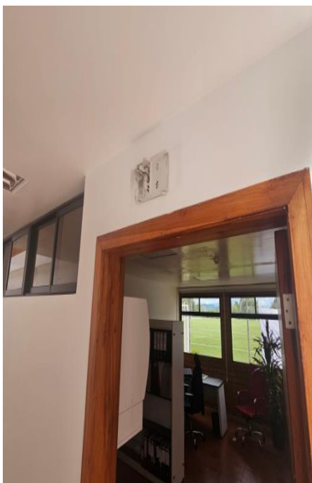
Ruta de Evacuación NO FUNCIONAL LAMPARA RETIRADA APARENTEMENTE POR CORTO CIRCUITO
